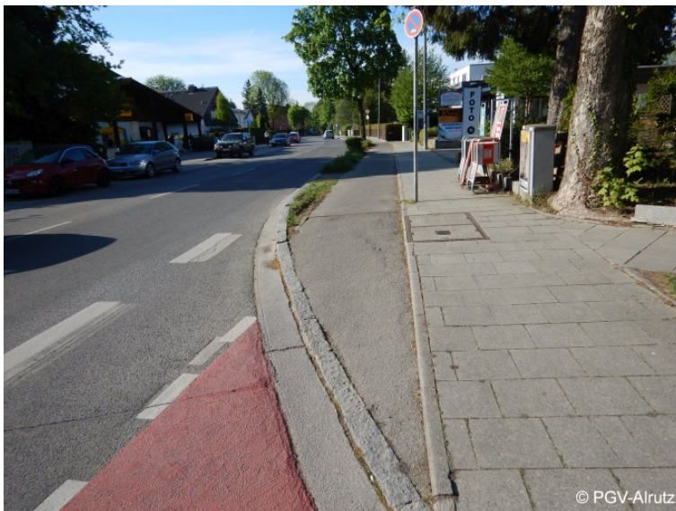
Abb. 5-8: Nicht benutzungspflichtiger baulicher Radweg in unzureichender Breite (Gröbenzell, Bahnhofstraße)
